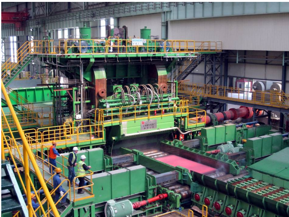
Fertigerüst des 4,3-Meter-Grobblechwalzwerks von Siemens bei Jinan Iron & Steel
