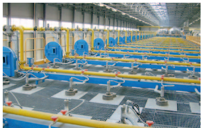
Durch die Verwendung von IE2-Motoren von Siemens können jährlich Energiekosten von 62.000 Euro eingespart werden.
