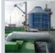
Infraserv Biogas Frankfurt- Höchst Germany
